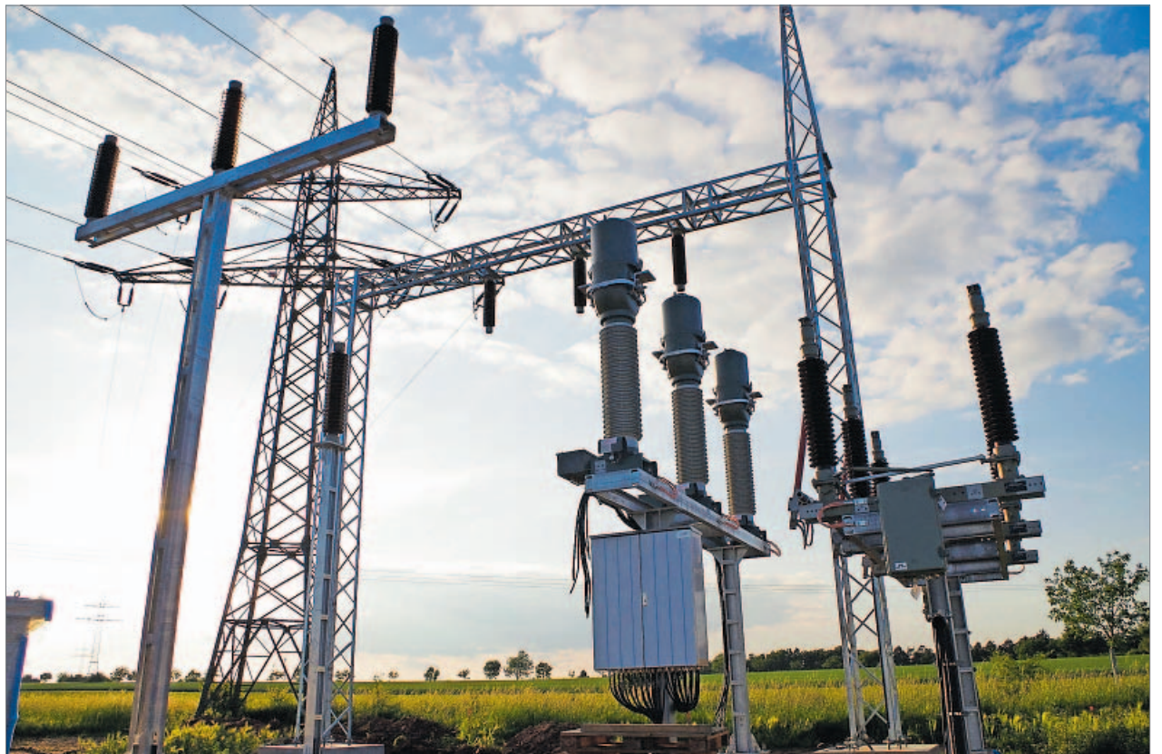
Erneuerbare Energien sind Investitionen vor Ort. In Raindorf (Kreis Fürth) errichtet zurzeit eine Bürger-Windenergiegesellschaft ein eigenes Umspannwerk, um den Ökostrom ins Regionalnetz der N-Ergie einzuspeisen. Foto: Heinz Wraneschitz
